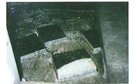
熱交換器内部のスケールが溶解し、受水槽にコロイド状の堆積物として凝集してくる
